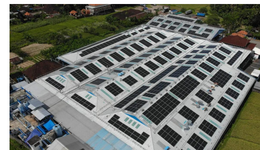
■ 印尼达能DANONE 3MWp光伏电站项目 Danone Indonesia 3MWp PV project
