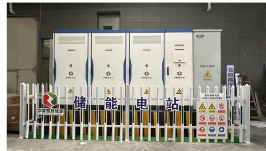
■ 浙江华夏智慧1MW/2MWh储能项目 Zhejiang Huaxia Zhihui 1MW/2MWh BESS Project
