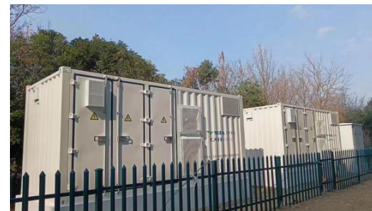
■ 上海世博洲际酒店 1MW/2MWh储能项目 InterContinental Shanghai Expo 1MW/2MWh BESS Project
