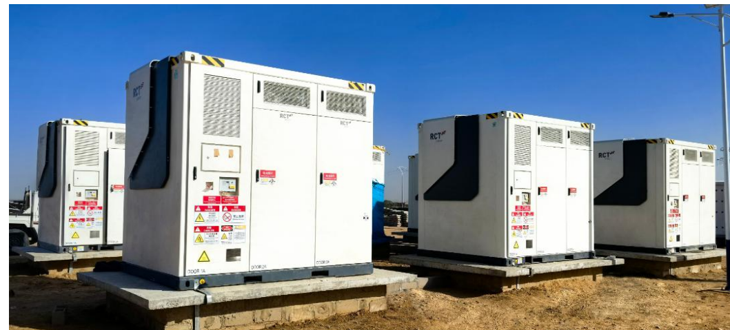
■ 非洲盖雷达1.08MW/3.888MWh光储柴微电网项目 Africa Guereda 1.08MW/3.888MWh solar-storage-diesel microgrid project
