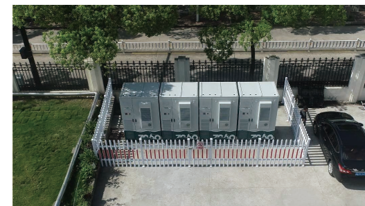
■ 杭州滨江康恩贝光伏配储项目0.6MW/1.2MWh Hangzhou Kangenbei 0.6MW/1.2MWh BESS Project
