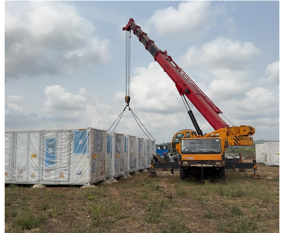
■ 加纳100MWh储能项目 Ghana 100MWh Energy Storage Project
