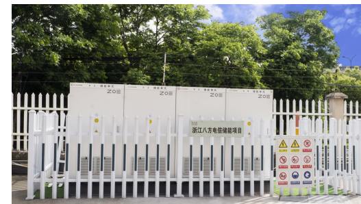
■ 浙江八方电信有限公司0.372MW/0.744MWh储能项目 Zhejiang Ba Fang Telecom 0.372MW/0.744MWh BESS Project
